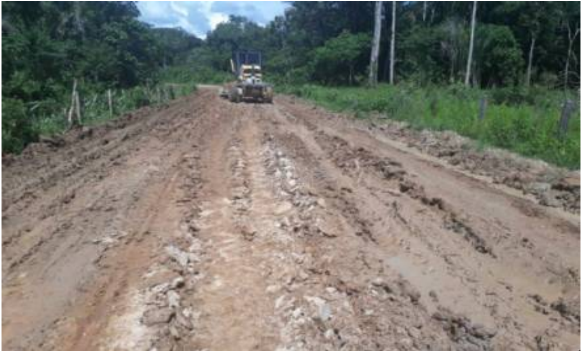
FOTO No 3 ESTADO INICIAL DE LA VÍA
