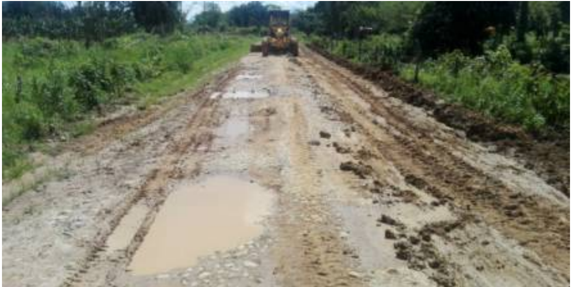
FOTO No 1 ESTADO INICIAL DE LA VÍA
